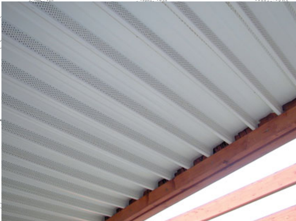
Aspect intérieur avec un système HAIRAQUATIC en toiture
